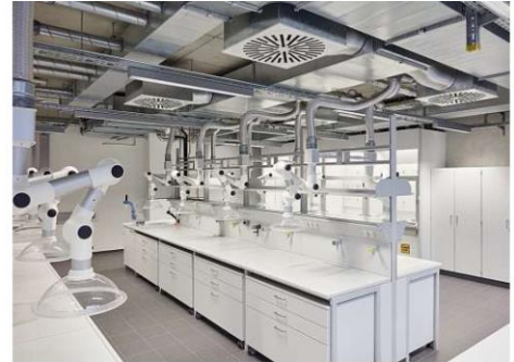
3 Das Labor Analytik enthält 16 Chemie-Arbeitsplätze mit jeweils einer Punktabsaugung, die in die Medienzellen integriert ist.
